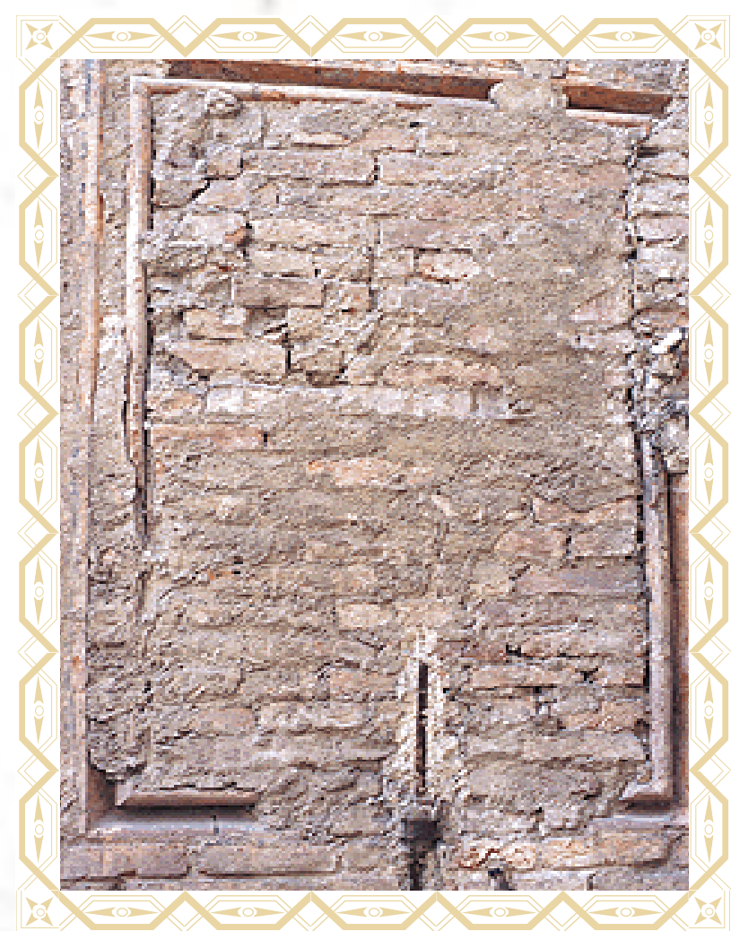
Le cornici di elementi in cotto delimitavano finestre chiuse in età successiva (Foto di A.R.)
