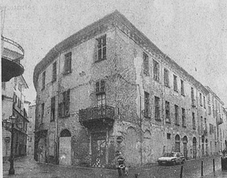
Palazzo Siccardi in vicolo Santa Maria angolo via Barbaroux con lo storico portone barocco semidistrutto
